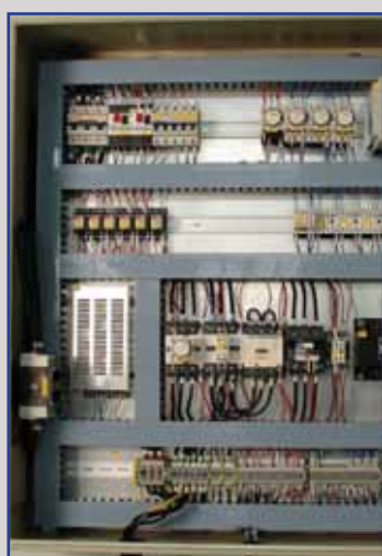
Quadro elettrico con componenti Siemens, Telemecanique.
